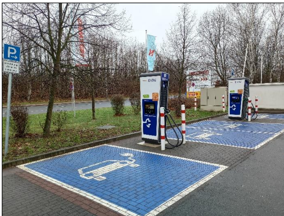
Abbildung 16: Bestehende Ladeinfrastruktur für Elektrofahrzeuge im Gewerbegebiet Bückethaler Landwehr
